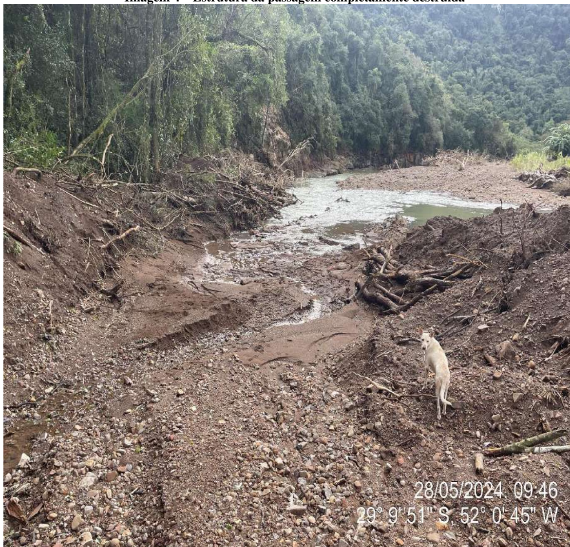
Imagem 4 – Estrutura da passagem completamente destruída
