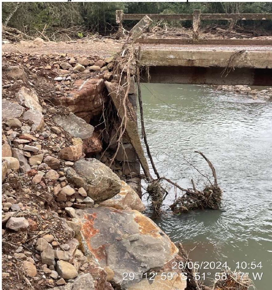
Imagem 5 – Detalhe da cabeceira comprometida
