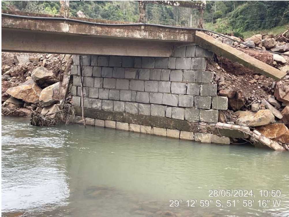
Imagem 4 – Detalhe da cabeceira comprometida
