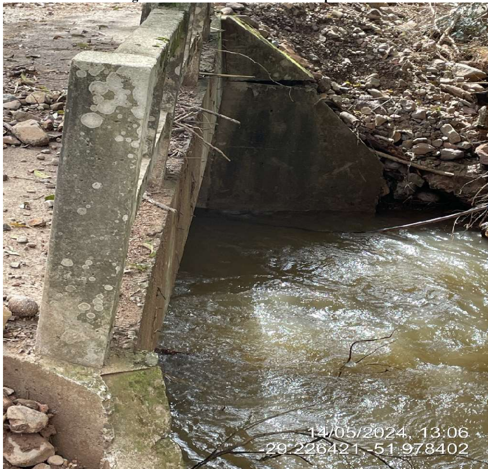
Imagem 5 – Detalhe da cabeceira comprometida
