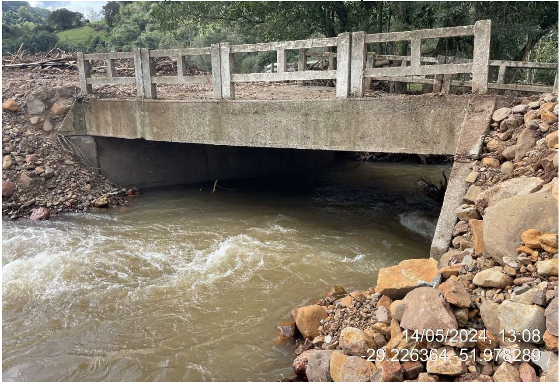
Imagem 4 – Detalhe da cabeceira comprometida
